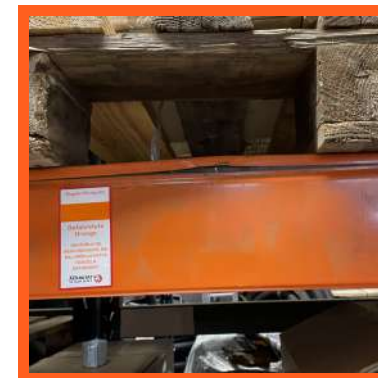
nach oben beschädigtes Kantprofil
