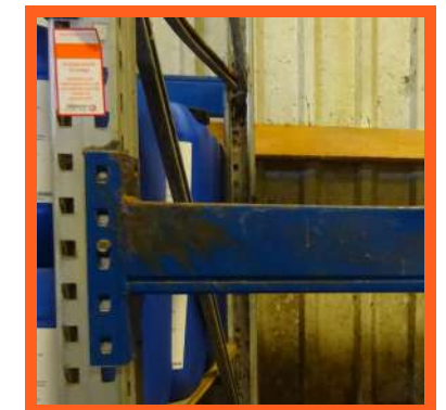
ausgeprägte Korrosion des Rahmenprofils und der Traverse
