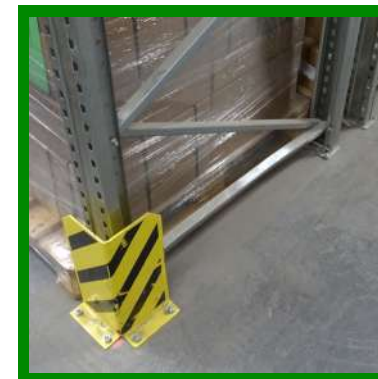
leicht beschädigte horizontale Fachwerkstrebe
