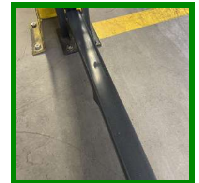
leicht beschädigte horizontale Fachwerkstrebe
